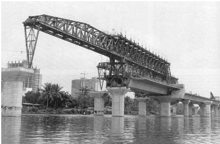
Fig.5.10: Scorrimento della trave di varo sugli appoggi temporanei sulle pile nella direzione della campata da realizzare.
