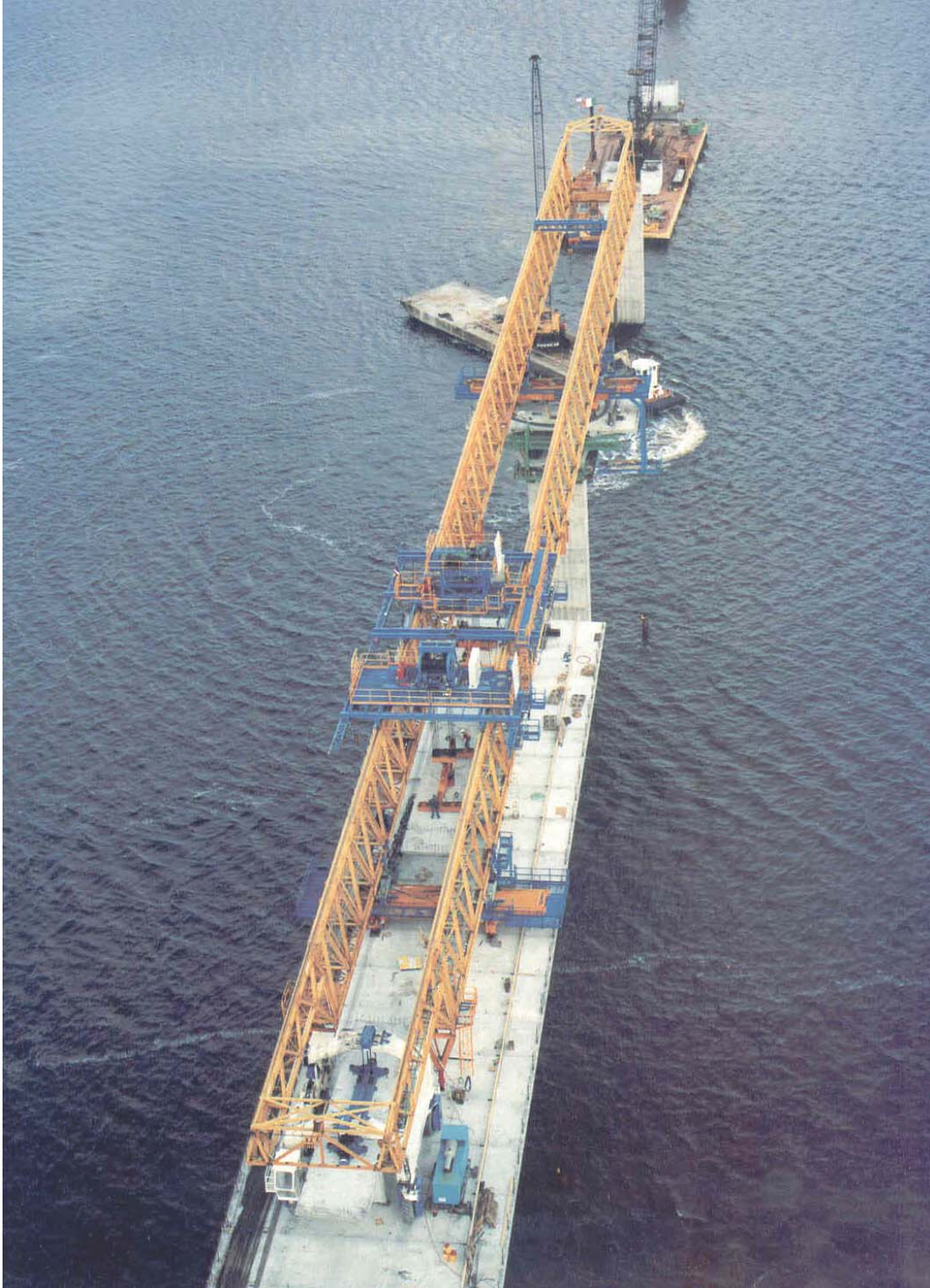
Fig. 5.13: Il trasporto della gru a supporto delle operazioni di montaggio del carro di varo è avvenuto per mezzo di una chiatta.
